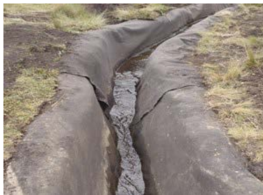
Imagen 5: Zanja de coronación trapezoidal (permite albergar mayor volumen) revestido con una capa de geosintético para estabilizar el terreno
