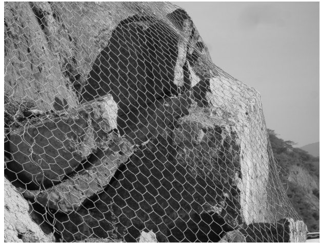
Fotografía 10.2 Control de caídos de roca utilizando mallas ancladas.
