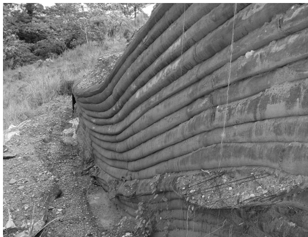
Fotografía 6.3 Falla de un muro MSE.
