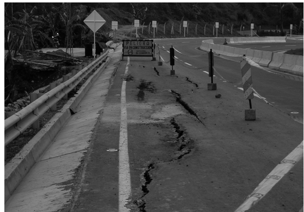
Fotografía 6.2 Falla de un muro MSE por exceso de deformación en los refuerzos.
