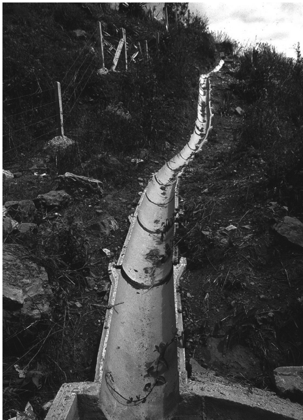
Fotografía 2.2 Sistema de canales prefabricados para el drenaje de los taludes.
