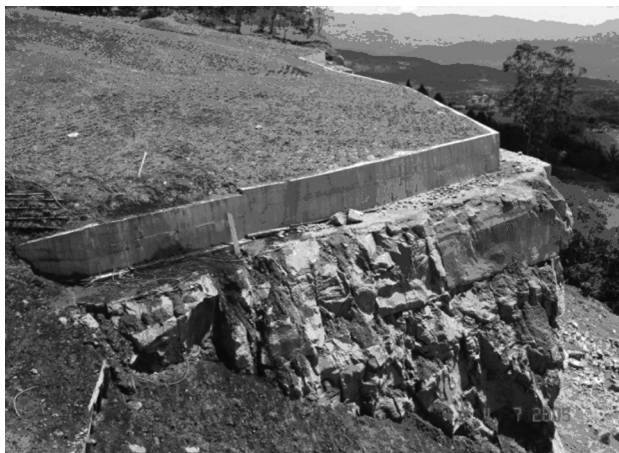
Fotografía 3.2 Muro de gravedad para contener el deslizamiento de un coluvión arcilloso sobre una formación de areniscas.
