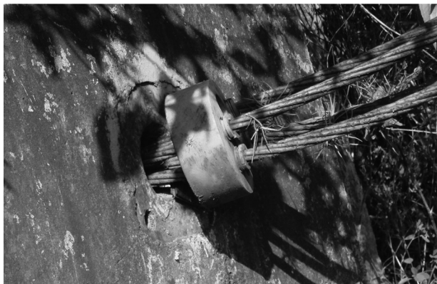
Fotografía 4.3 Falla por extracción del ancla.
