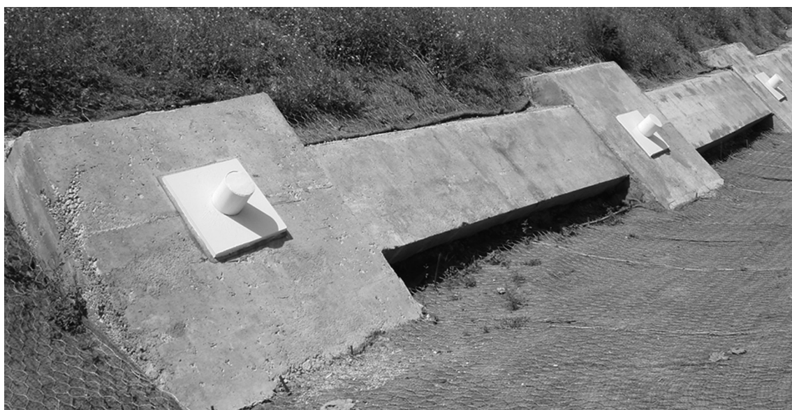
Fotografía 1.3 Estructura con elementos individuales de concreto armado como apoyo de las anclas pretensadas.
