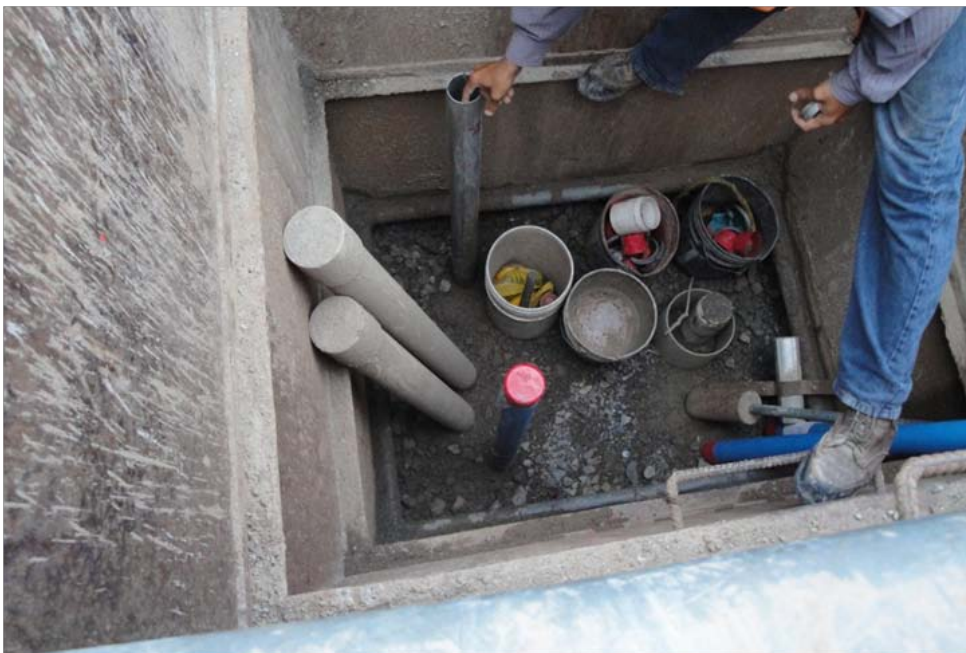
Figura 5.16 Instalación de tubos guía de plástico y de aluminio dentro de una caja metálica de protección durante la construcción de un terraplén
