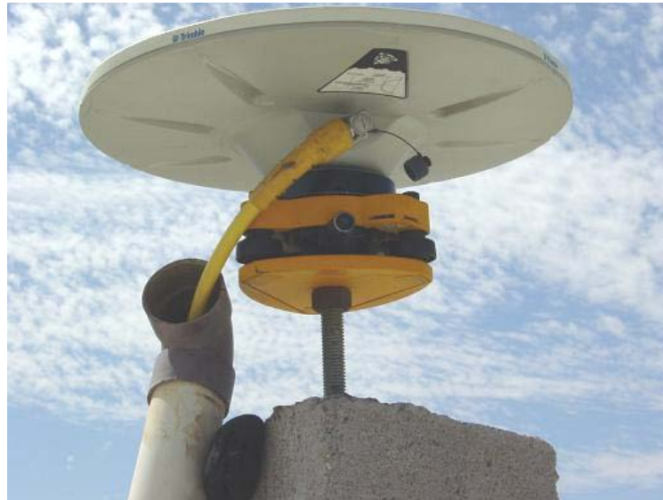
Figura 4.43 Instalación de antenas satelitales de la Red Geodésica Nacional Activa (cortesía INEGI)
