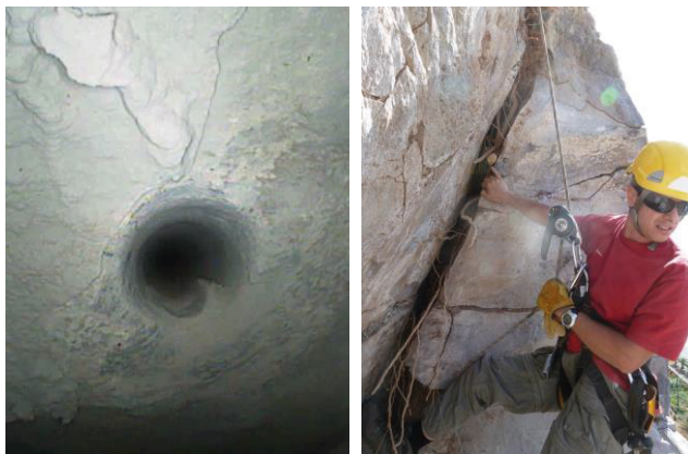
Figura 16. Izda: Perforación horizontal P-4. Grieta abierta >de 40cm a los 3,5m de profundidad. Dcha: Labores de auscultación del talud. Bloque inestable y efecto de las raíces sobre la grieta abierta.
