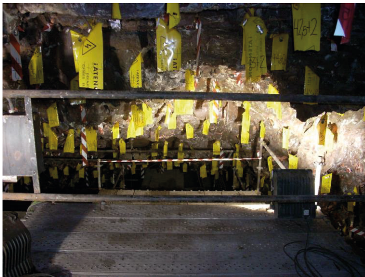
Figura 18. Clave del auditorium con identificación individualizada de bulones colocados.
