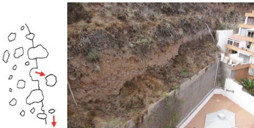
Figura 4. Inestabilidad por chineo o caída de bloques menores.
