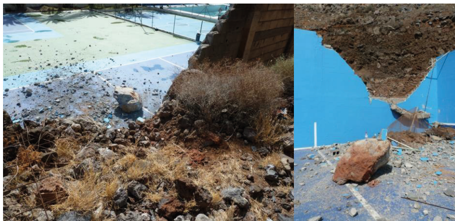
Figura 6: Daños en el muro del frontón producidos por el impacto del bloque desprendido.
